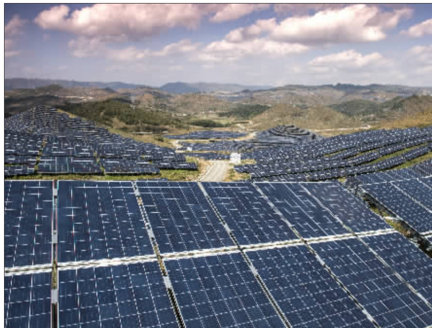
总投资4亿余元的普安县楼下镇磨舍村瑞辉光伏发电站建成投营。该项目于2015年11月开工建设,光伏总发电量为5569万千瓦时。目前已并入地方电网供电。图为远眺瑞辉光伏发电站。本报记者 邢贵龙 摄
